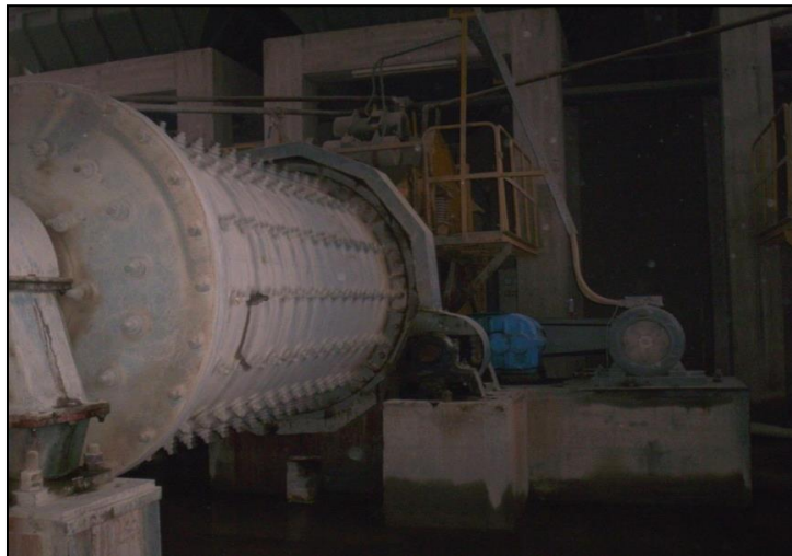
řekil 6. Mersin-Fındıkpınarı krom zenginleřtirme tesisi deđirmen katı genel görünümü.
